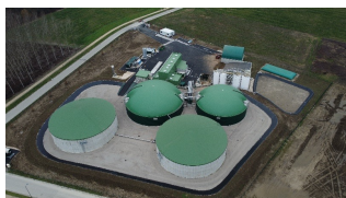
CVE Aoste : Investissement local de la commune et de la Communauté de communes dans le projet
